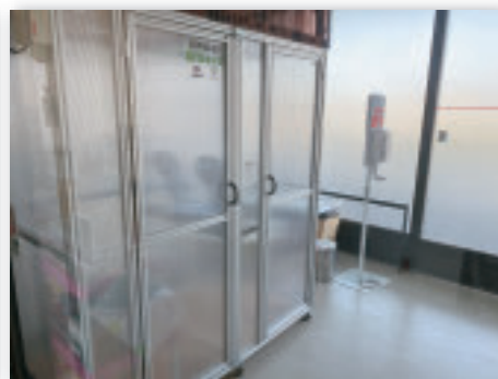
救急入口に設置の非接触型PCR検査室
